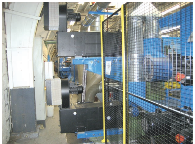
Antriebsseite des Querschneiders, gut erkennbar die neuen Motore.
